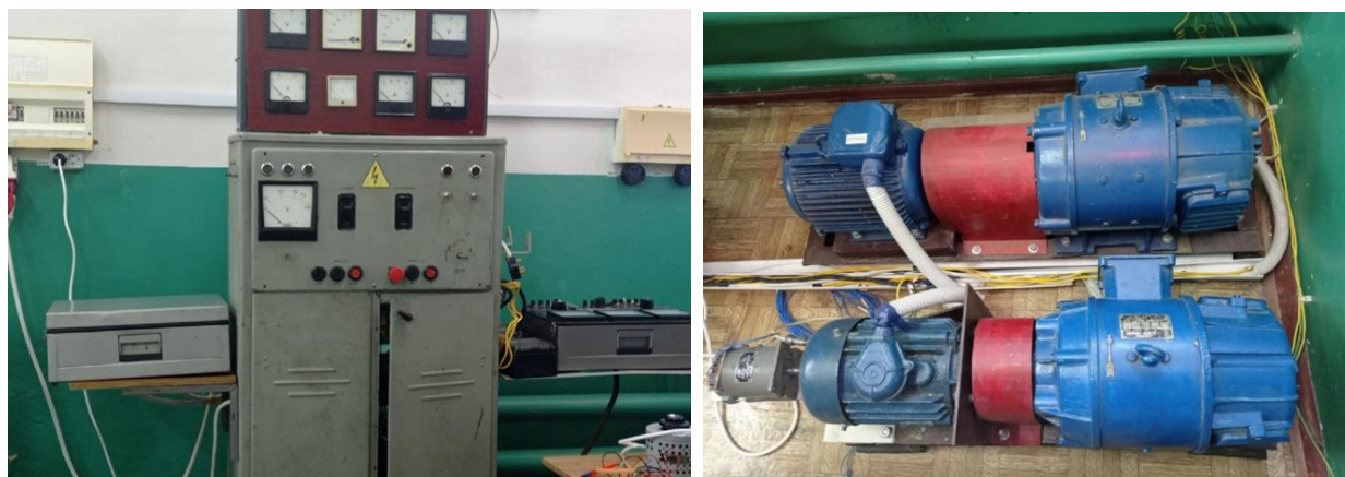
Рис. 4. Общий вид комплексного испытательного стенда
