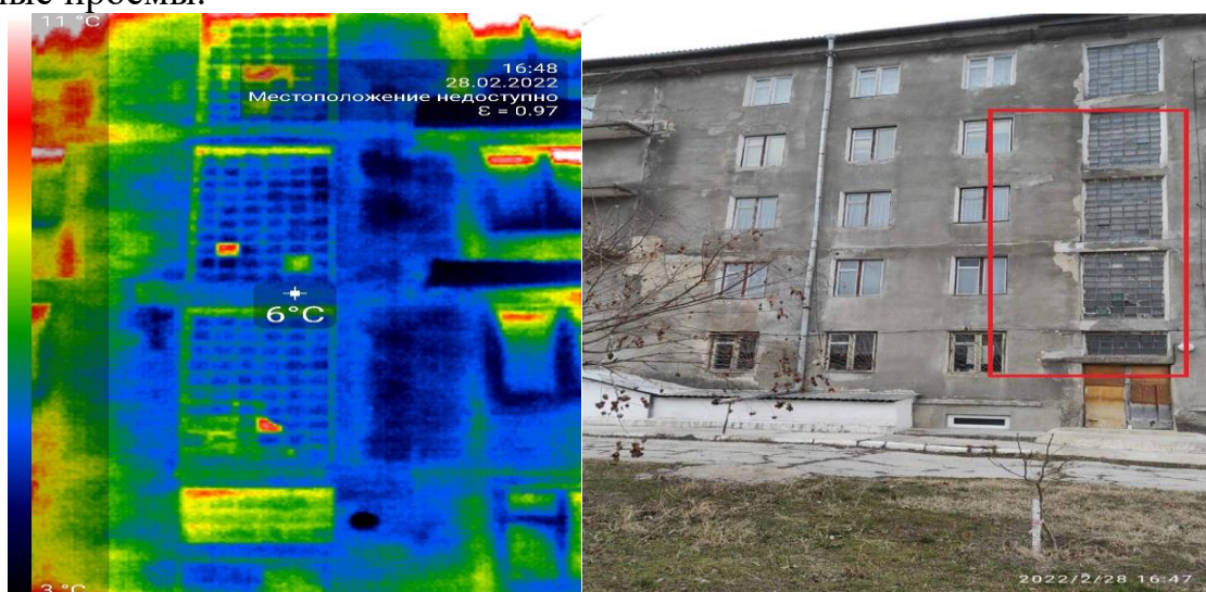
Рис. 2. Терммограмма части фасада здания корпуса «Б»
