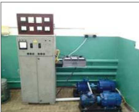
Рис. 1. Общий вид комплексного испытательного стенда со шкафом управления
